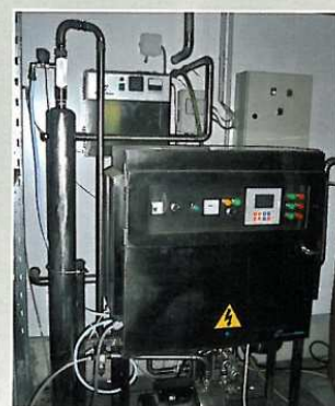
■ Deux générateurs sont installés de l'autre côté des murs de l'atelier dédié au saumon et au sushi. Indépendants, l'un traite l'air et l'autre l'eau, en remplissant un stock tampon.
