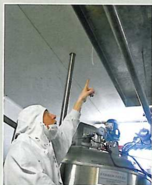
■ Dans l'ensemble des sites, des buses de plastique ont été déroulées dans les doubles plafonds. Elles sont reliées au générateur d'ozone et permettent de diffuser un air traité dans les pièces où elles arrivent.
